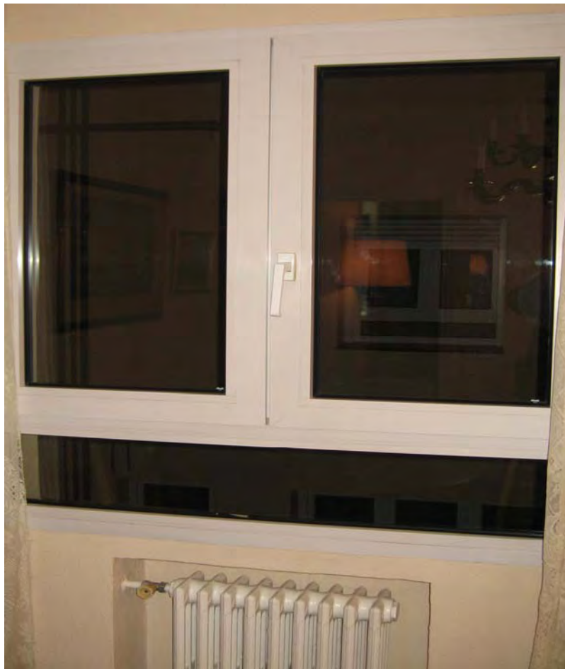
Foto 21. Carpintería PVC con doble acristalamiento banal.
