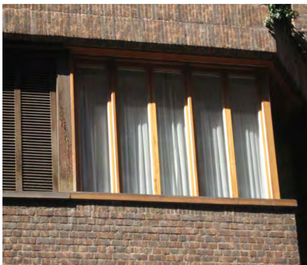
Foto 19. Carpintería de madera con doble acristalamiento banal.
