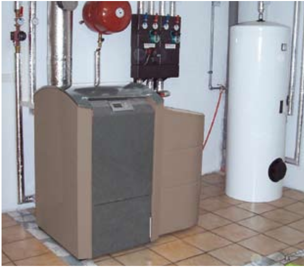
Figura 21: Almacenamiento integrado con la caldera
