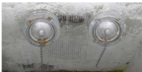
Figura 10: Toberas de carga neumática del silo
