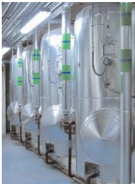
Producción de ACS central con depósito de acumulación.
