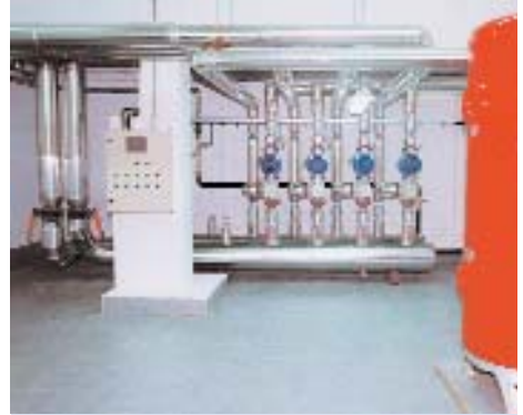
Reforma de sala de calderas en la que se han realizado cuatro circuitos de calefacción independientes.
