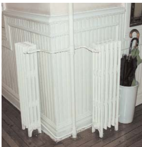
Radiadores de hierro fundido de una instalación con distribución por montantes; únicamente disponen de llave de corte en la entrada.
