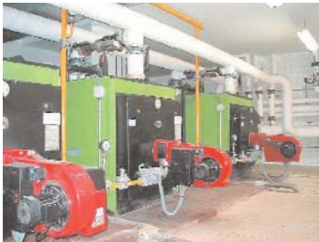
Calderas pirotubulares con quemadores mecánicos a gas
