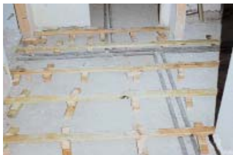
Distribución interior bitubo, desde las distribuciones generales se llevan las derivaciones de cada radiador
