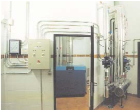
Sala de calderas para calefacción y ACS en un edificio de viviendas.
