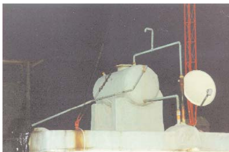
Vaso de expansión abierto de una instalación de calefacción central, situado en la cubierta del edificio.
