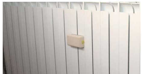
Evaporímetro para medición del consumo de calefacción individual.
