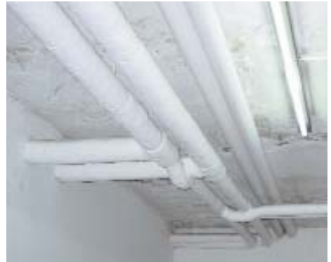
Distribución general de calefacción única, sin llaves de corte en cada ramal; la accesibilidad de la misma permite efectuar distribuciones independientes por orientaciones, además de poder instalar llaves de corte y de equilibrado en cada montante.
