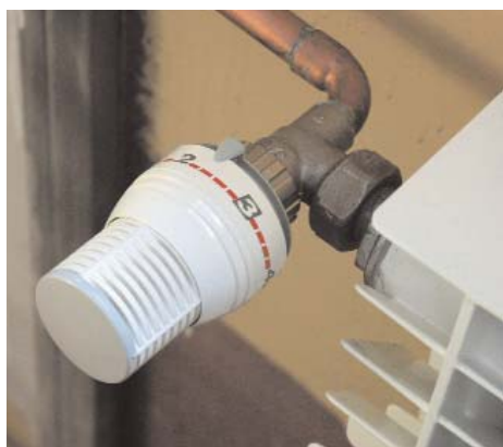
Válvula termostática en radiador con distribución bitubo.
