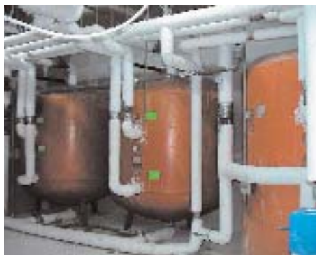
Producción central de ACS con depósitos calentados por el sol y depósito calentado por las calderas.
