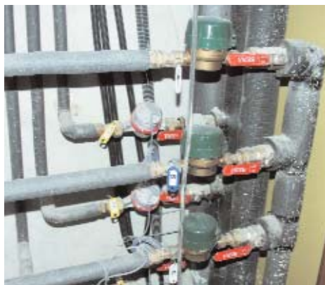
Conjunto de contadores de ACS, en primer plano, y de agua fría en una instalación centralizada de calefacción y ACS.
