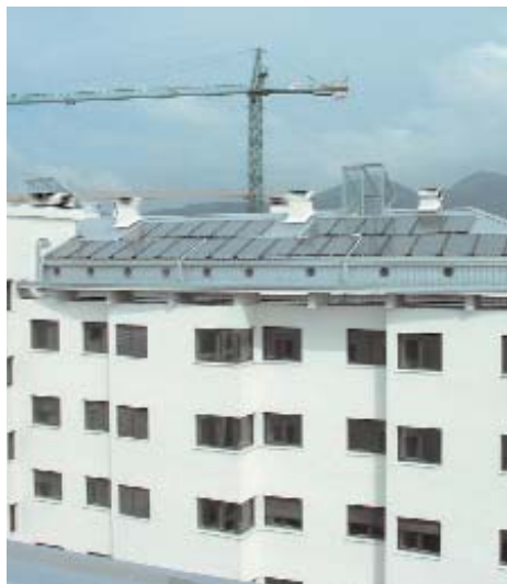
Captadores solares para ACS central
