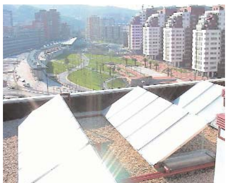
Captadores solares térmicos para producción de ACS central en un edificio de viviendas.
