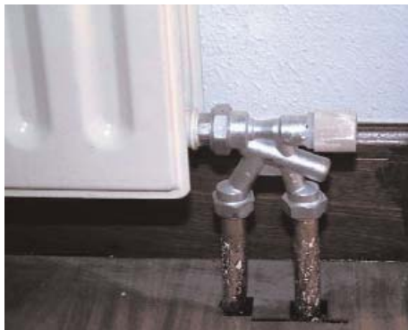
Radiador con conexión monotubo, con llave de corte que incorpora el detentor de reglaje.
