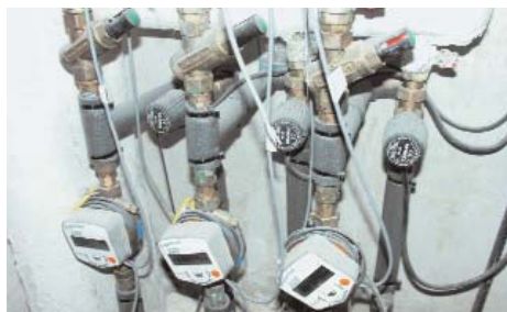
Contadores individuales de energía de calefacción, válvulas de zona y válvulas de equilibrado por vivienda.
