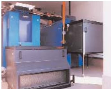
Calderas a gas de baja temperatura y condensación, con capós insonorizados para cubrir los quemadores.
