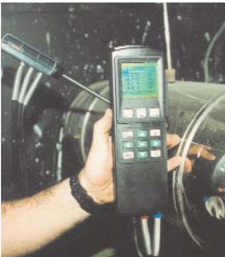
Comprobación del rendimiento de combustión del generador de calor.
