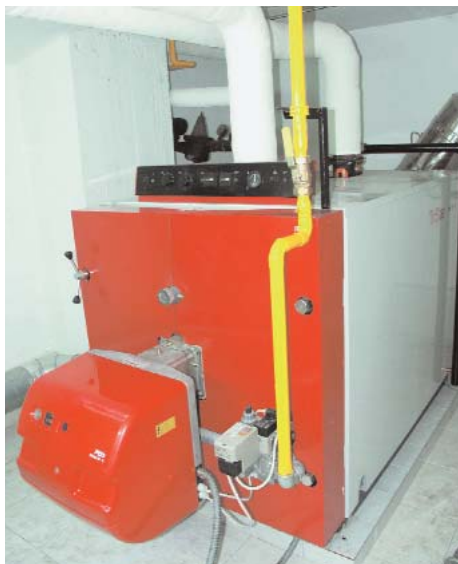
Caldera pirotubular con quemador mecánico a gas
