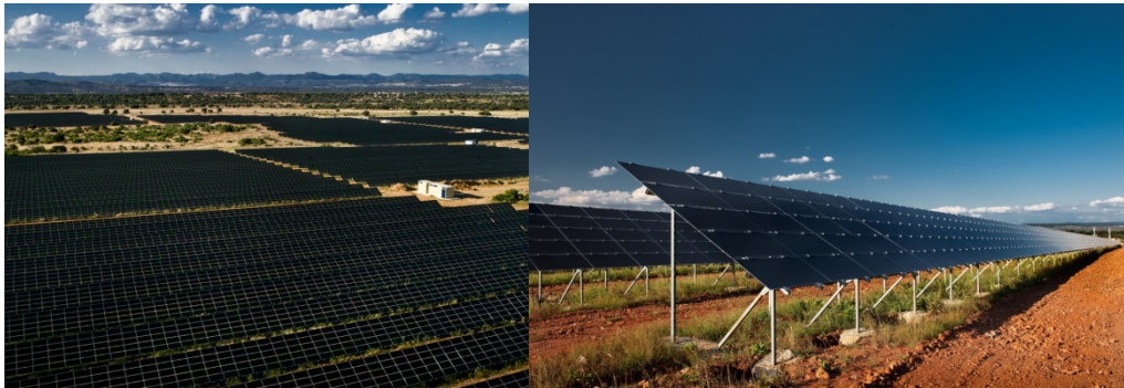
Fig. 7. Vista de la planta fotovoltaica de Valdecaballeros y detalle de los módulos fotovoltaicos sobre estructura fija.
